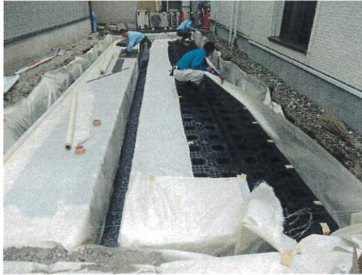
免震基礎工事中土木シート巻き込み
